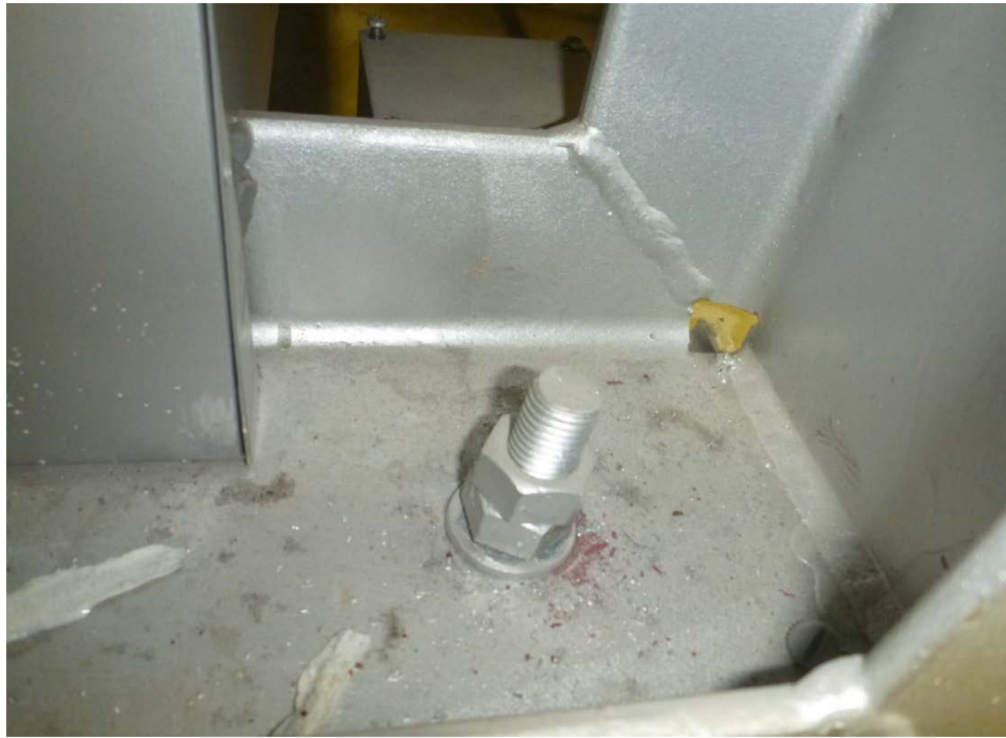
冷温水発生機基礎ボルト緩み
