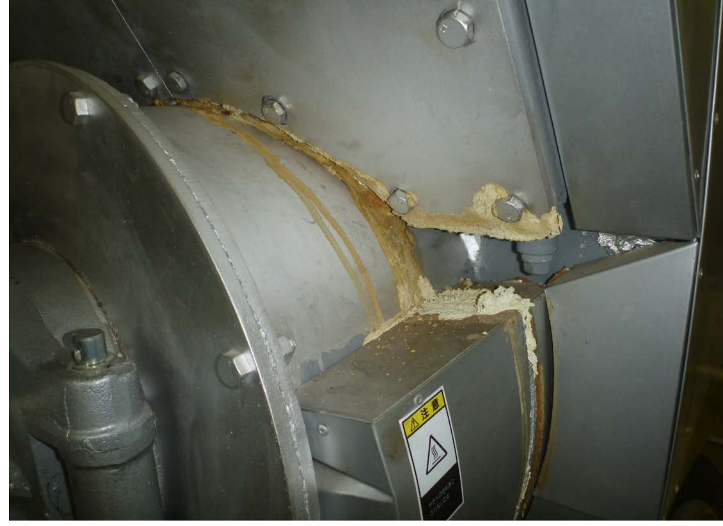
冷温水発生機劣化状況
