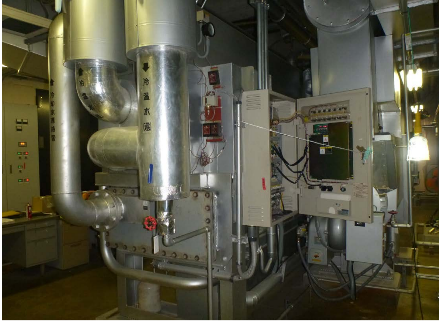
冷温水発生機外観
