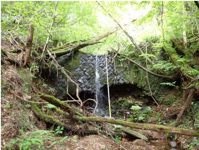
（左写真） 練石積谷止工の基礎部が 経年劣化により崩壊している。
