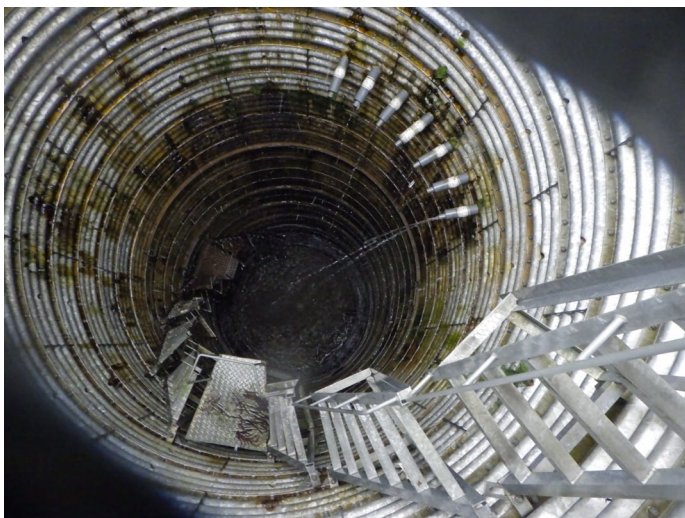
(左写真) 地すべり防止施設として整備された集水井工
