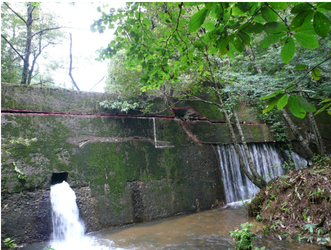
(左写真) 堤体に亀裂が生じるなどし、何らかの対策が必要な治山ダム
