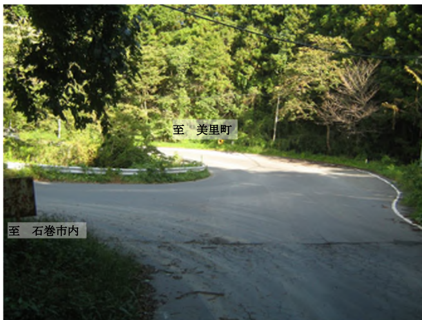
線形不良箇所
