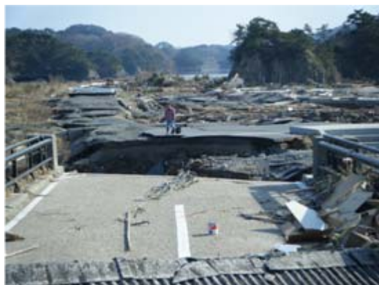
奥松島松島公園線 松ヶ島橋背後が津波により流出
