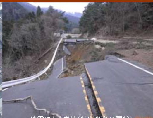
地震による崩壊(牡鹿半島公園線)
