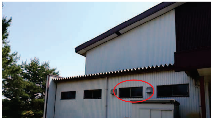
アリーナの外壁面のガラスも割れているものがあります。
