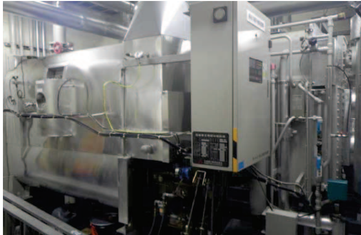
冷温水発生機 外観
