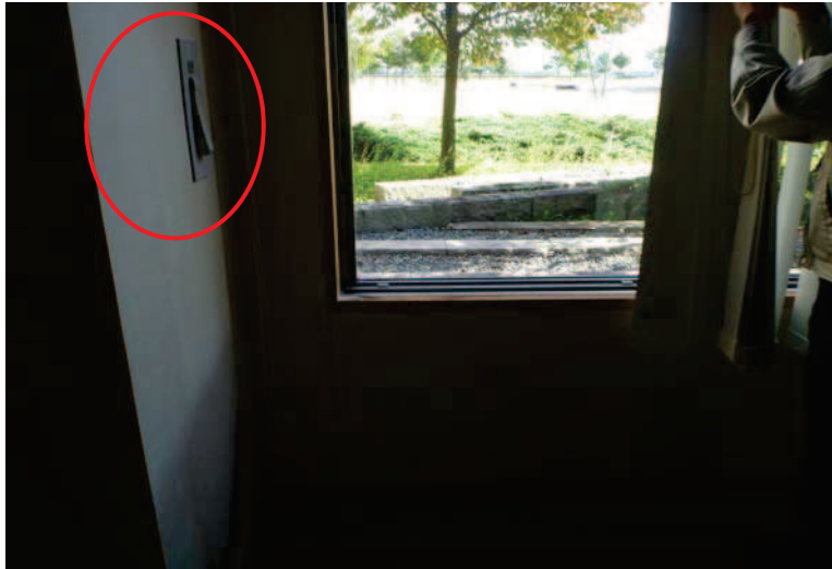
応接室の排煙設備のハンドル。 他の部屋や廊下にもありますので, 定期的に関閉確認願います。
