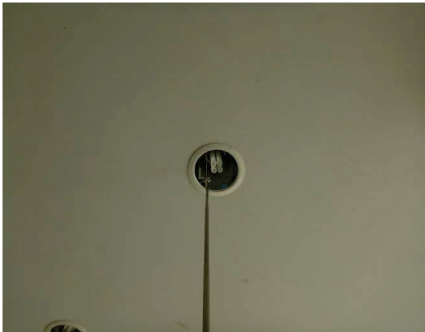
エントランスホール吹き抜けの階段を登り切った2階廊下の非常用照明。写真以外の箇所も確認が必要
