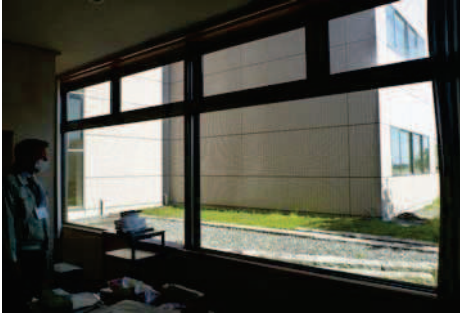
場長室サッシ周りの漏水状況。
