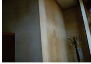
場長室 内壁の漏水状況。
