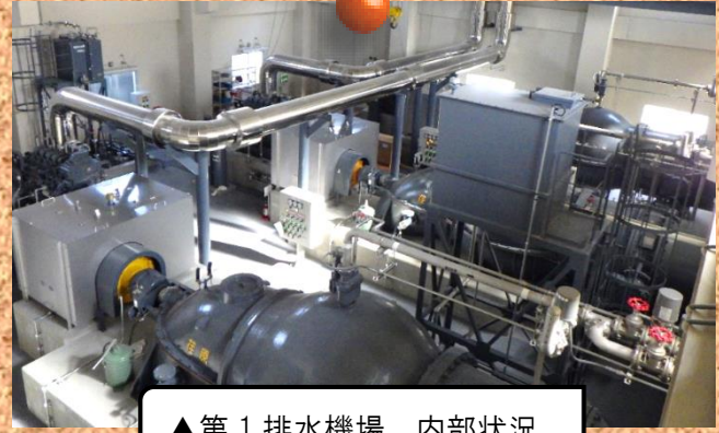
▲第 1 排水機場 内部状況
