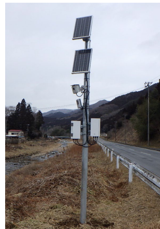
監視カメラ 設置状況(津谷川)
