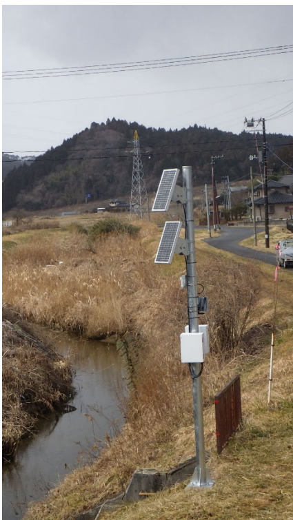
監視カメラ 設置状況（新川）
