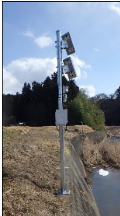
監視カメラ 設置状況（七北田川）
