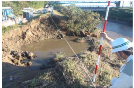
砂押川の破堤状況
