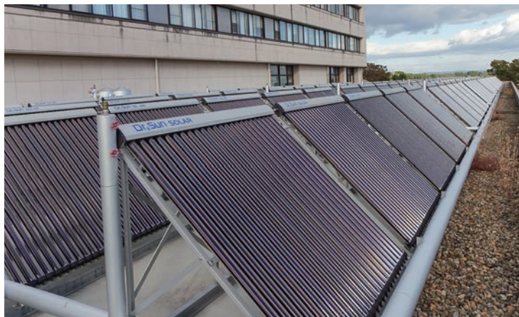
屋上に設置した太陽集熱パネル
