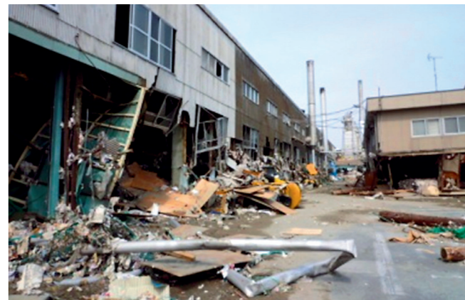
被災した合板工場(石巻市)
