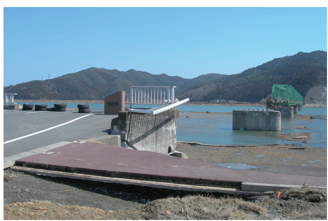
被災した新北上大橋
