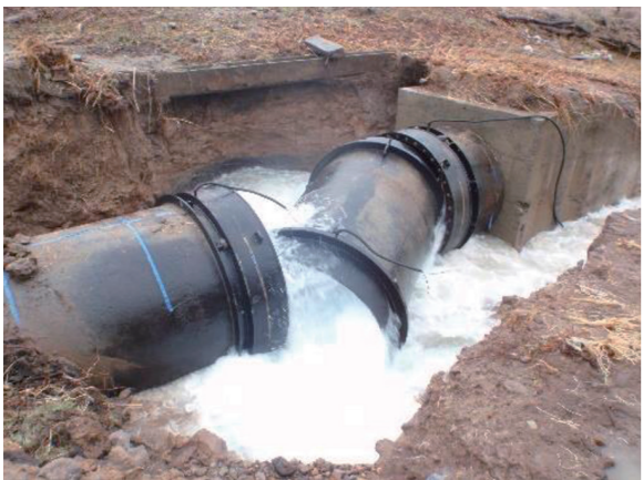
仙南・仙塩広域水道の漏水(白石IC付近)
