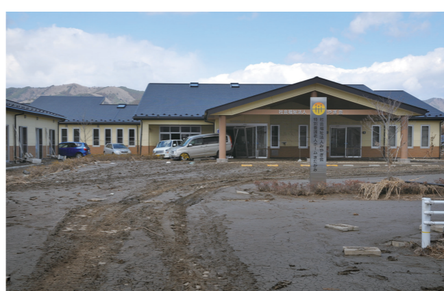
石巻市内高齢者福祉施設の被害
