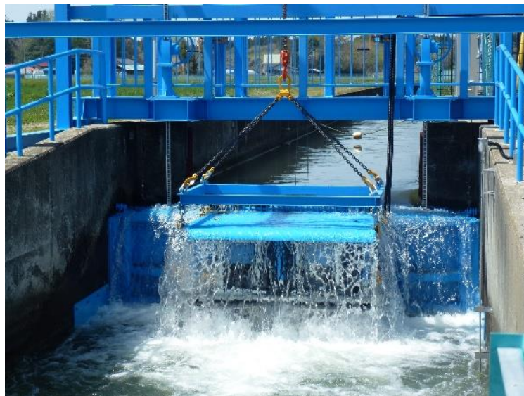
農業用水路を活用した小水力発電施設
