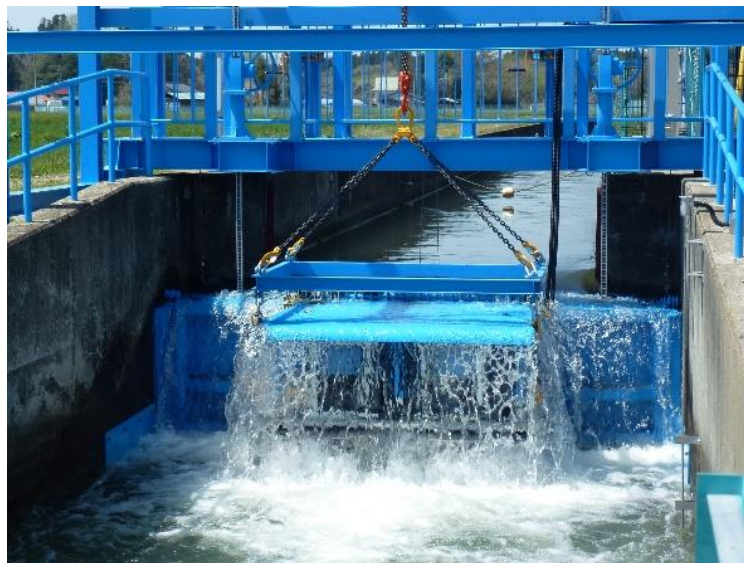
小水力発電施設
