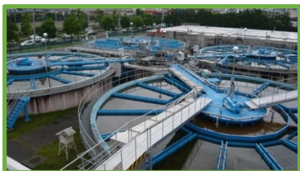
大樋浄水場（仙塩工水）
