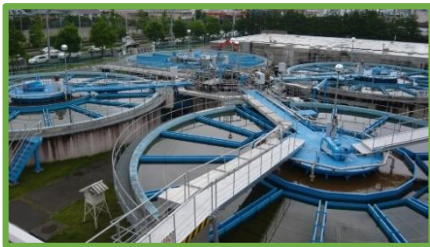
大樋浄水場（仙塩工水）
