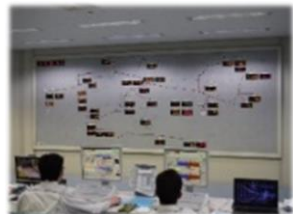
流量・水圧等の監視 (24時間・365日)
