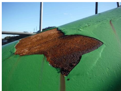
劣化した水管橋の塗装 (定期的に塗装するもののいずれ更新)
