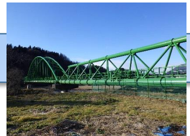
水道管 (送水管)
