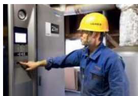
導入されたボイラー
