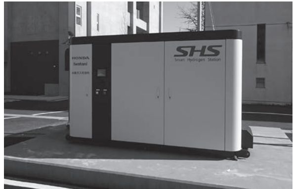
▲スマート水素ステーション
