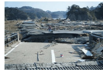
松島東松島公園線 (東松島市) 被災状況
