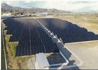
白石太陽光発電所（白石市）
