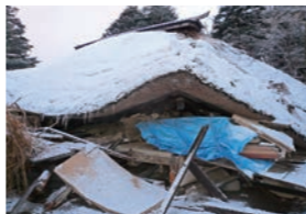
被災直後の主屋倒壊状況。
