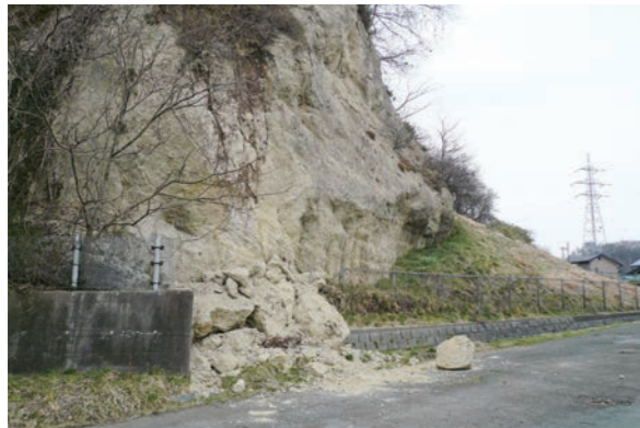
西側崖面の崩壊による落石。
