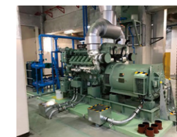
写真：令和2年度 石巻東部浄化センター自家発電設備(完了)
