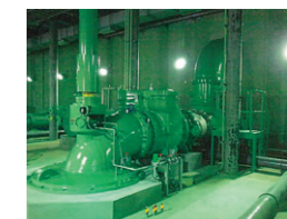
写真：令和2年度 仙塩浄化センター汚水ポンプ(完了)
