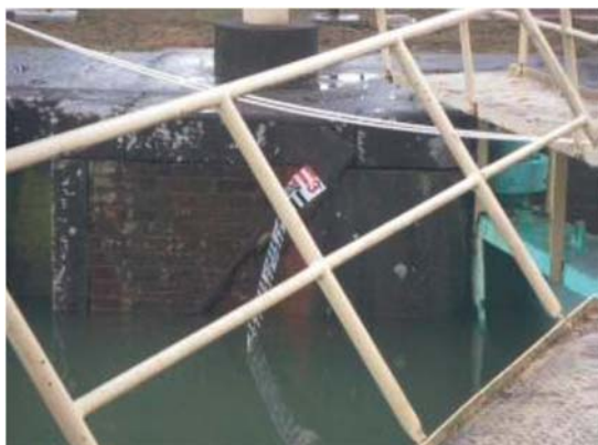
写真6.4.9 剥がれた量水標と変形した 門扉天端の手すり
