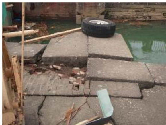
写真6.4.8 沈下・欠損の拡大
