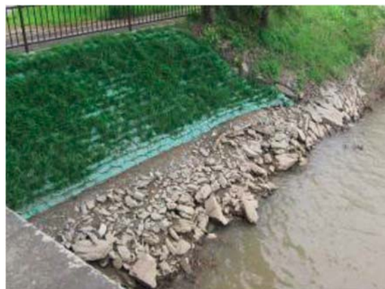
写真6.4.10 取り付け部法面の崩落
