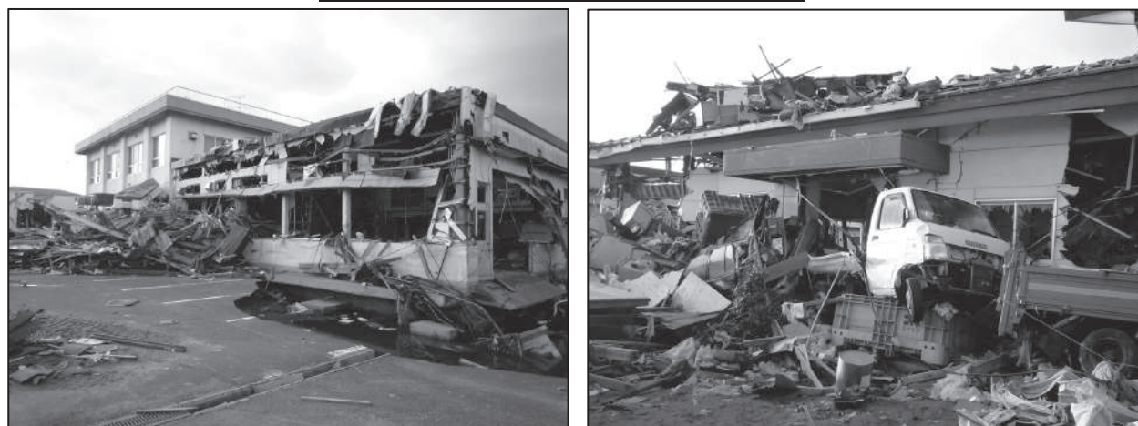
津波の被災を受けた水産加工開発部の建物
