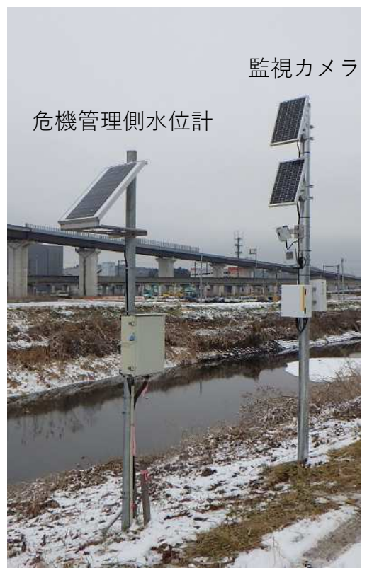
監視カメラ 設置状況（砂押川）
