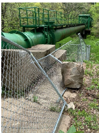
川原子沢水管橋 フェンス破損状況
