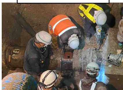
令和5年 柴田町船迫漏水状況 (腐食による穿孔)
