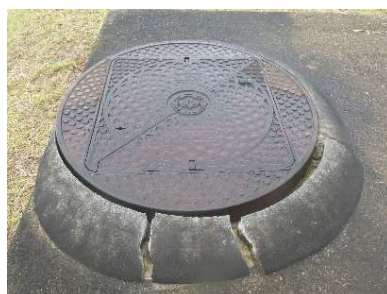
マンホール（高区幹線AV-21） 破損状況
