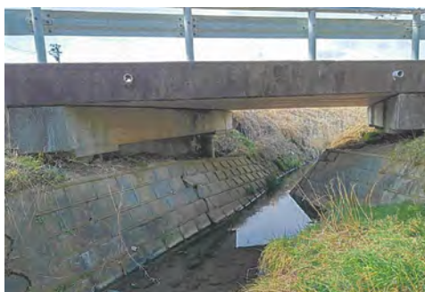
管理用道路橋の 護岸破損状況
