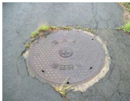
マンホールの 経年劣化状況
