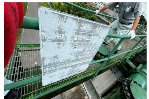
管路標識の 経年劣化状況
