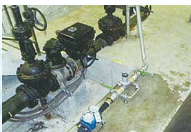
緊急給水システム
