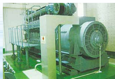
非常用ディーゼル発電機 (1,750KVA)
