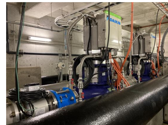
小水力発電設備
