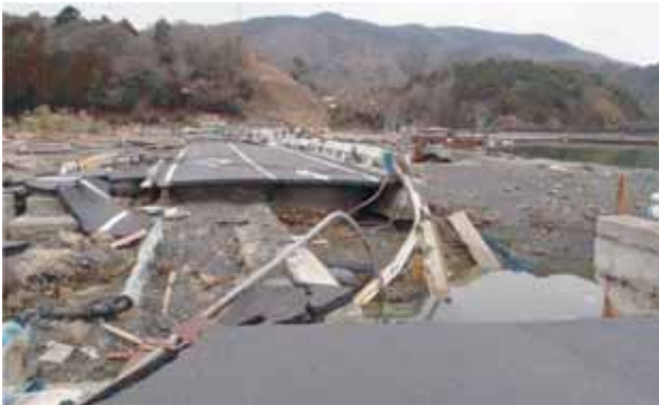
女川牡鹿線（被害状況）
