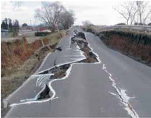
迫川 栗原市若柳大林地内（被害状況）
