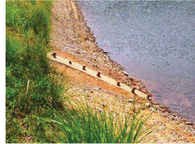
老朽化した取水施設
