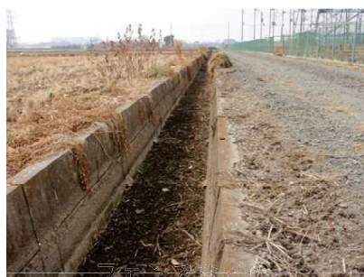
安全施設がない水路
