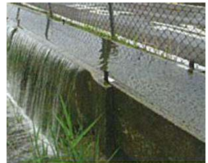
水路からの溢水
