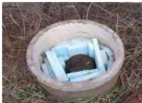
給水栓ボックス内の保温状況
