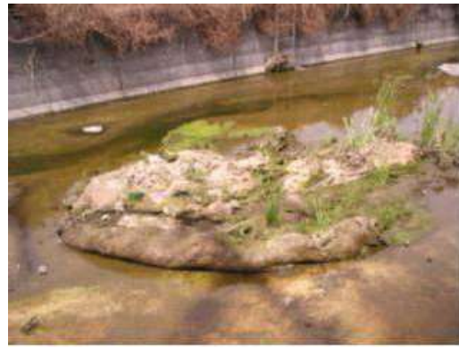
土砂の堆積状況
