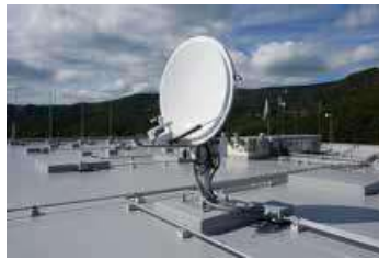
衛星回線用アンテナ
