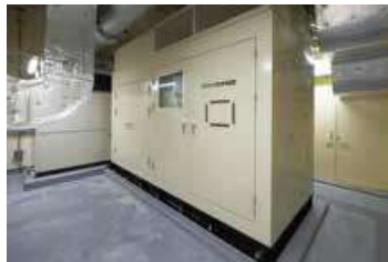
非常用自家発電機
