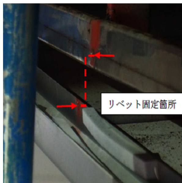
骨組み留め付けリベットの抜け
