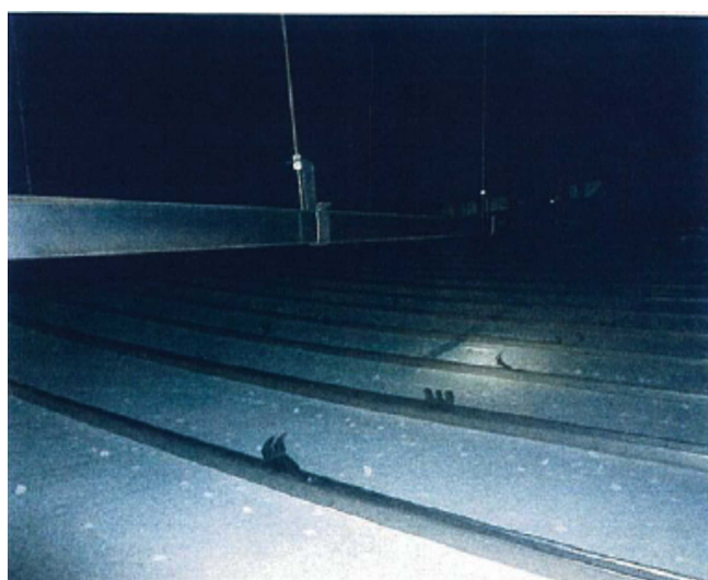
天井内クリップの外れ
