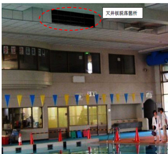
天井立ち上がり部脱落状況
