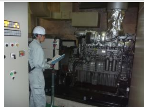
県民会館非常用発電設備の試験調整状況確認の様子
