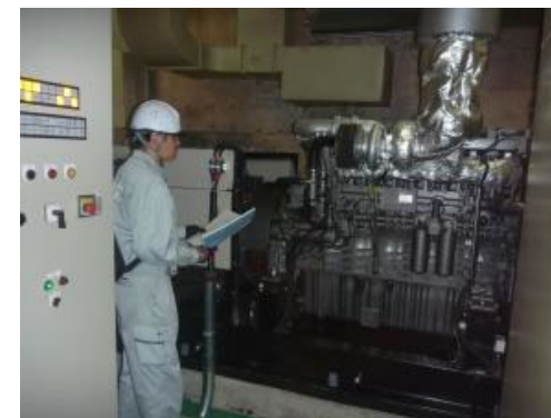
県民会館非常用発電設備の試験調整状況確認の様子
