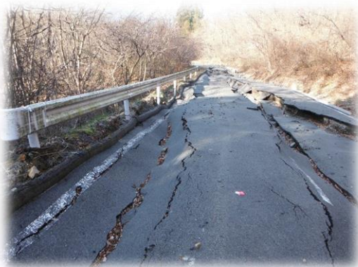
被災した大谷地線の様子
