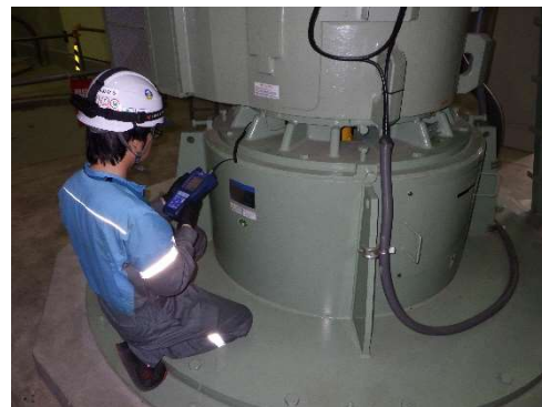
設備点検状況
