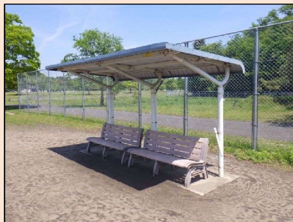
シェルター（腐食により更新）
