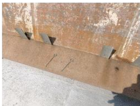
図 2.5.4 ウエザーシールのはずれ
