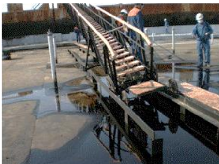
図 2.5.2 ローリンググラダーの脱輪
