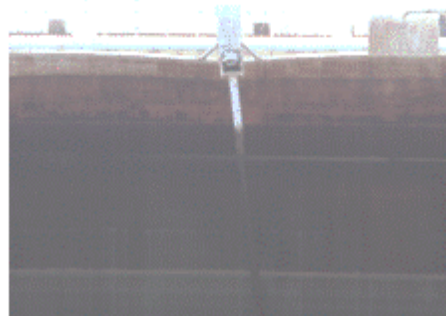
図 2.5.3 浮き屋根回転止め、側板の変形
