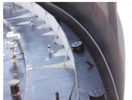
図 2.5.5 ポンツーン蓋の離脱
