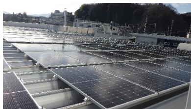
導入した太陽光発電設備
