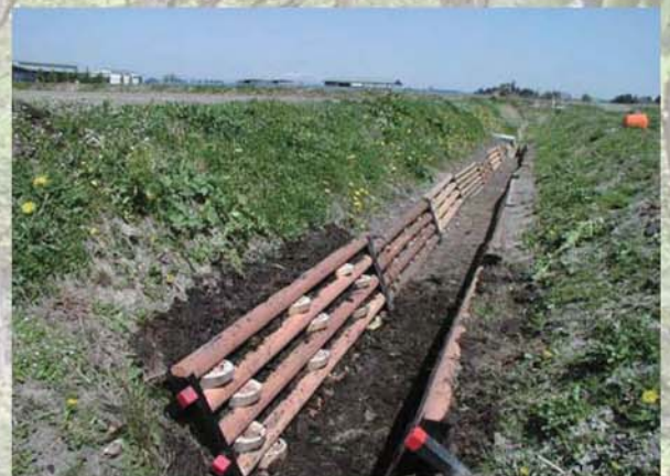
間伐材を利用した生物保全型水路 (p. 4 参照)
